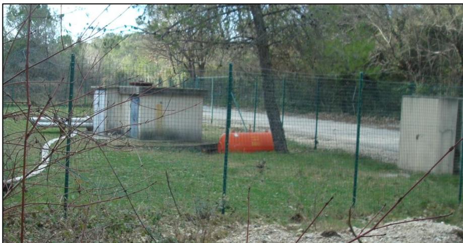
Vue de la station de pompage avec le local technique et la clôture
